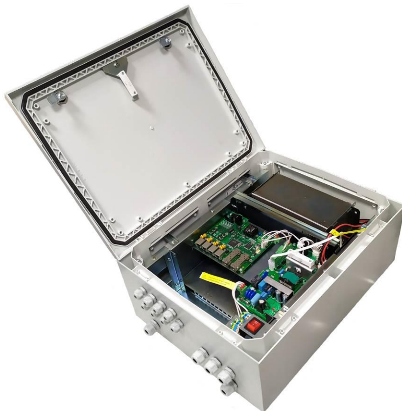
Рисунок 3.1.2 - PSW-2G+UPS-Box - вид внутри
